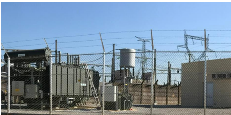
Figure 4a ; Aspect général d'un poste source
